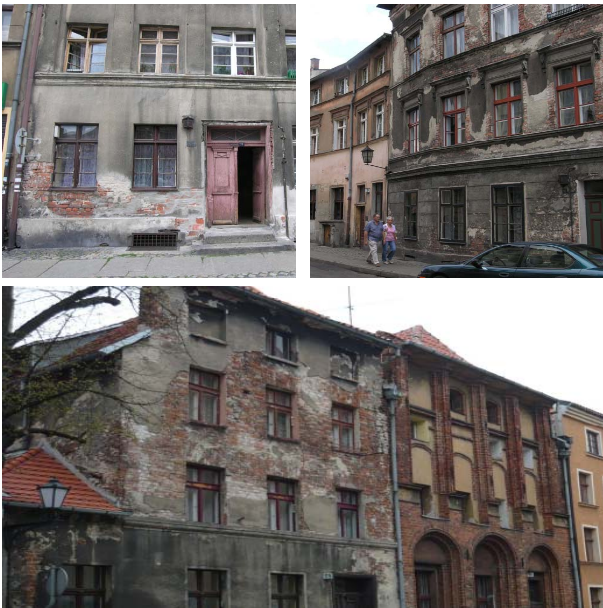
Ryc. 16. Degradacja budowlano-techniczna części zabudowy staromiejskiej
