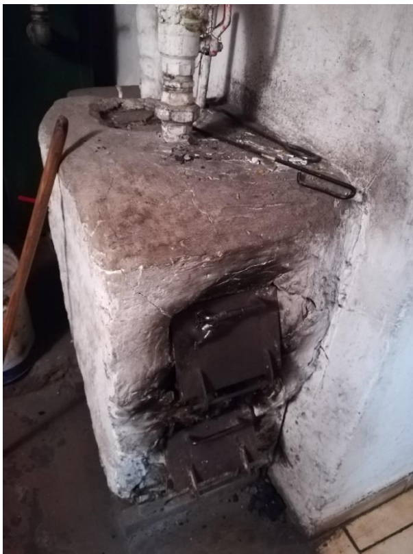
Fot. 2. Źródło ogrzewania - zdjęcie z kontroli Ekopatrolu, źródło: Straż Miejska w Bydgoszczy
